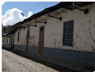
Casa colonial en mal estado. Como la de la fotografía, son varios los inmuebles patrimoniales que por falta de mantenimiento y a raíz del abandono están cayéndose a pedazos. Foto Felipe Osorio V. (2019).
