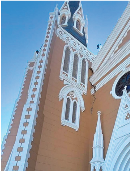
Afectaciones en la iglesia de Abejorral ocurridas el lunes 10 de agosto - Foto: cortesía
